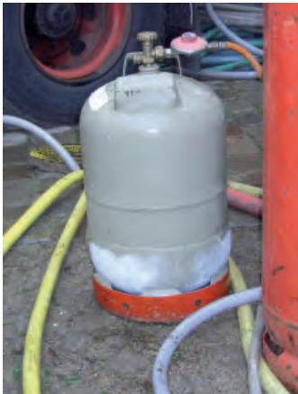
Abb. 4: Flüssiggasflasche mit Reifansatz; Flasche mit nicht geeignetem Druckregelgerät und unzureichende Aufstellung (verbotene Aufstellung im Verkehrsweg, Stolperstellen durch Schlauchleitungen)
