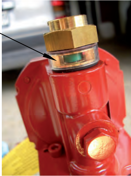
Abb. 12: Sichtanzeige (grün: Normalbetrieb, rot: Gaszufuhr unterbrochen)
