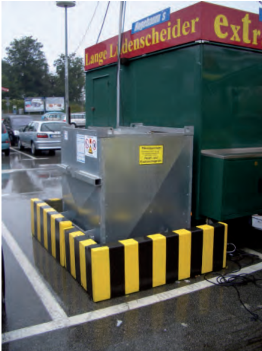
Abb. 49: Flüssiggas-Fass mit Schutzmaßnahmen (z.B. Anfahrerschutz, Flaschenschrank)
