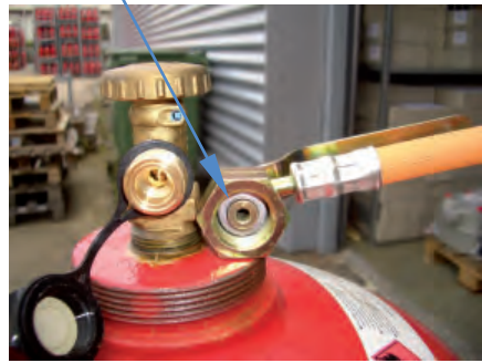
Abb. 15: Absperrventil 33 kg-Flasche und Hoch- druckschlauch mit Dichtring aus Aluminium
