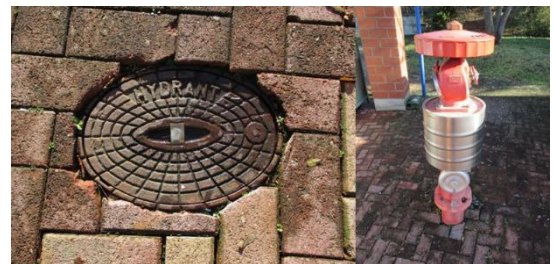
Abbildung 3: links. Unterflurhydrant, rechts Überflurhydrant
